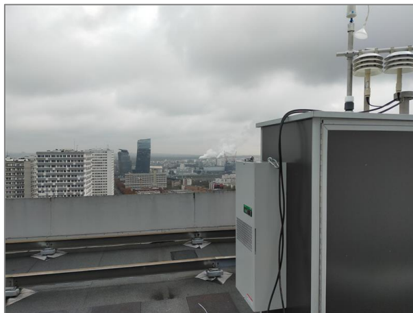
Figure 5 : Illustration de la station de mesure installée au sommet de la tour Ravenne permettant la mesure du dioxyde d'azote (NO 2 ) et des particules PM 10 et PM 2.5 .
